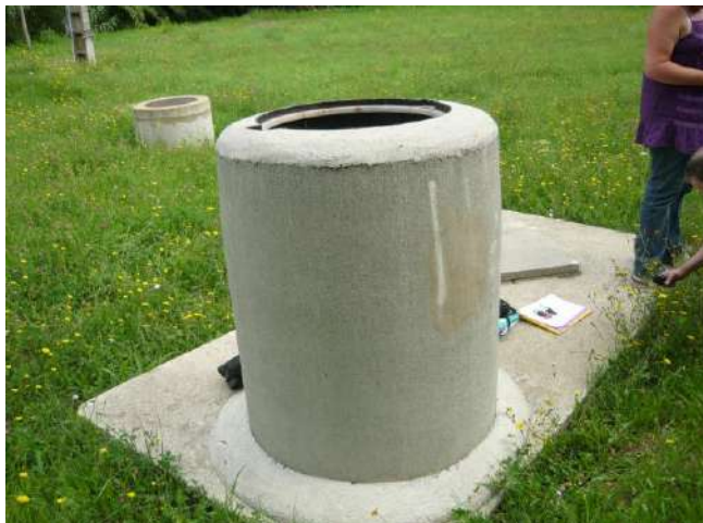
Photographie n°1 : Regard d'exploitation du forage F1
