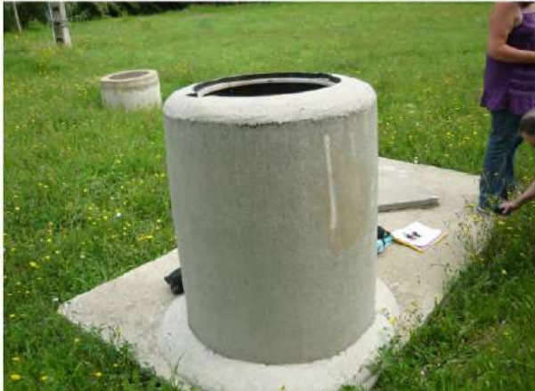
Regard d'exploitation du forage F1
