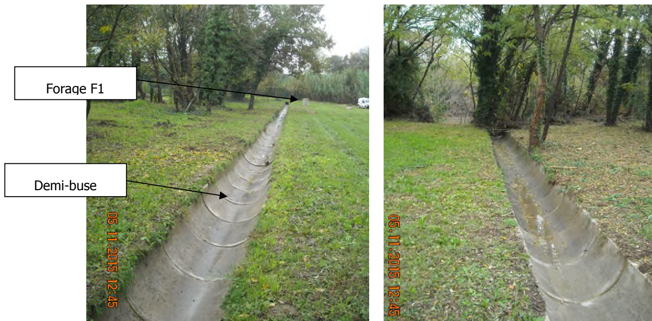
Demi buse béton traversant le PPI et exutoire
